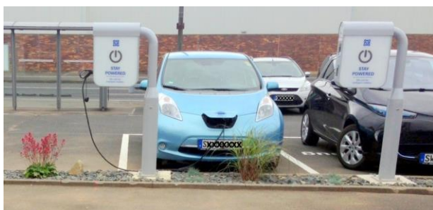
Foto links: Jeweils 2 E-Fahrzeuge können pro Ladestation parallel geladen werden. Die Ladegeschwindigkeit kann nach der Standzeitdauer, der Auslastung der Stromnetze sowie der Verfügbarkeit regenerativer Energien gesteuert werden.
