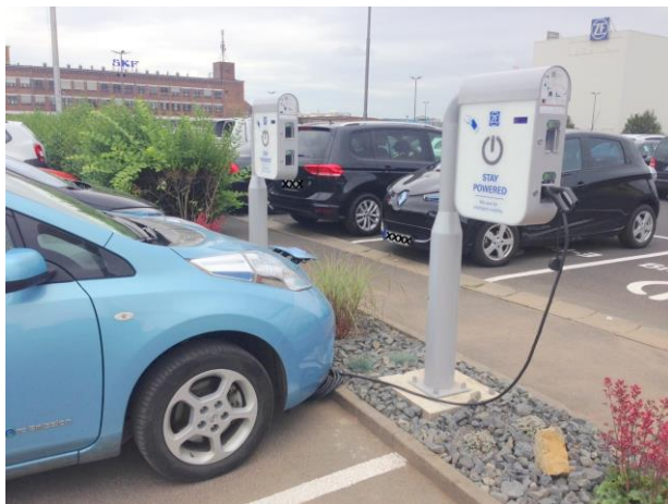
Foto links: Das Ladecluster bei ZF kann heute von allen Mitarbeitern genutzt werden. Die intelligente Steuerung der Ladeboxen sorgt für netz- und batterieschonendes Laden.
