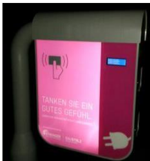
Foto links: Zur verbesserten Sichtbarkeit wird die Ladebox bei Dunkelheit von innen per LED beleuchtet.
