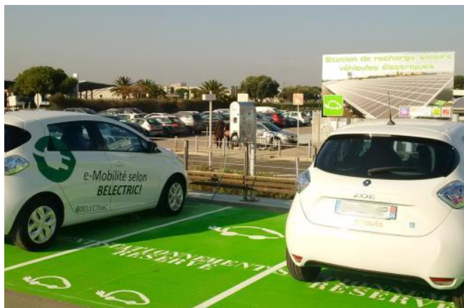
Bild: Dank der Montage mittels Standfuß lassen sich die BELECTRIC Ladeboxen äußerst platzsparend in die Parkbereiche integrieren.
