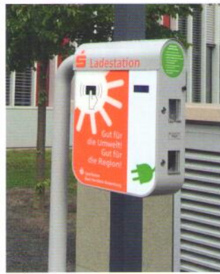
Die Elektrotankstelle der Sparkasse Bad Hersfeld-Rotenburg
